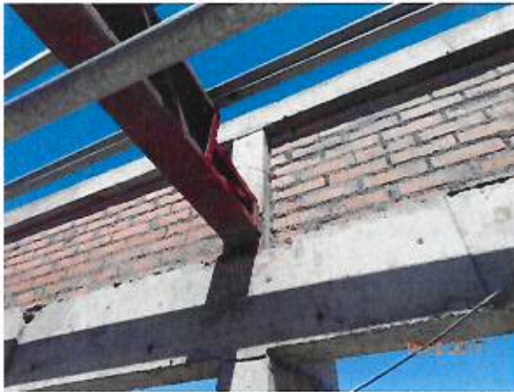
Fotografía N° 27: Fijación entre placa metálica embebida en el hormigón y cercha no ajustada a lo indicado en planos, en pabellón C (vista general).
