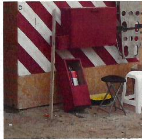
Fotografía N° 36: Extintor en el suelo.
