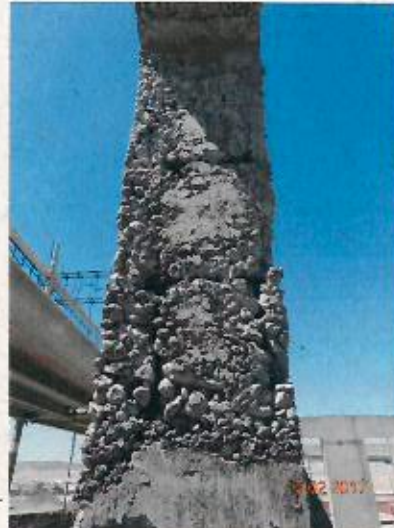
Fotografía N° 24: Nido con enfierradura a la vista en pilar del segundo piso del pabellón E, en las cercanías de la intersección de los ejes E1 y ED (vista cercana).
