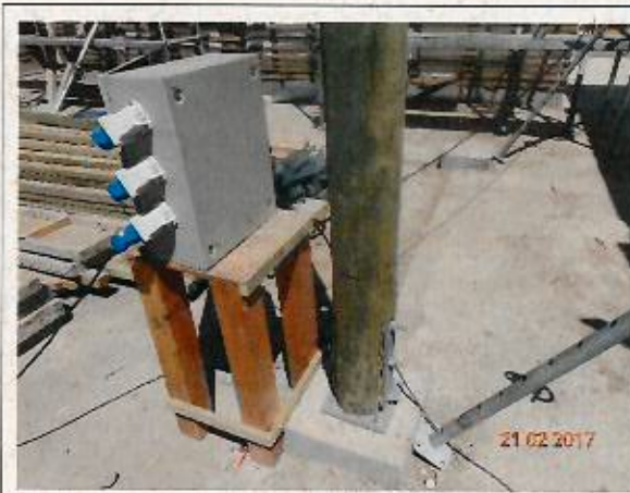
Fotografía N° 1: Anclaje de columnas de madera del patio interior no posee atiesadores indicados en plano de estructuras.
