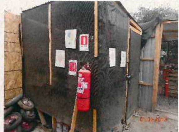
Fotografía N° 4: Extintor a la intemperie sin puerta de vidrio en su gabinete (ubicado en las bodegas de restauración).
