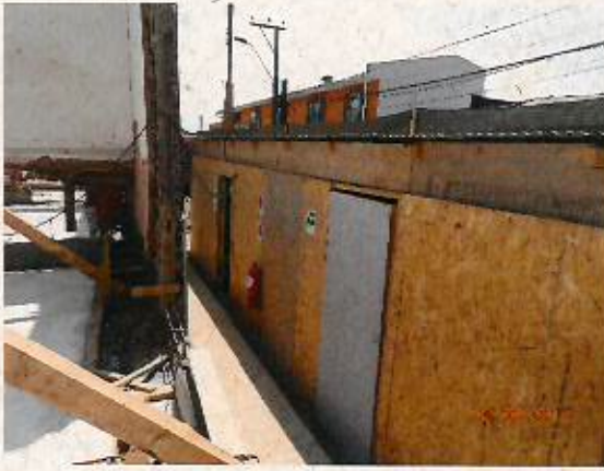
Fotografía N° 12: Extintor a la intemperie sin gabinete con puerta de vidrio.
