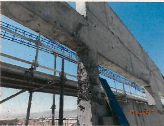
Fotografía N° 23: Nido con enfierradura a la vista en pilar del segundo piso del pabellón E, en las cercanías de la intersección de los ejes E1 y ED (vista general).
