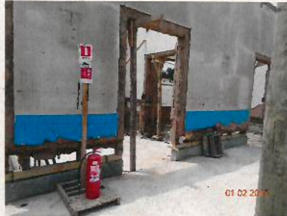
Fotografía N° 13: Extintor ubicado en el suelo.
