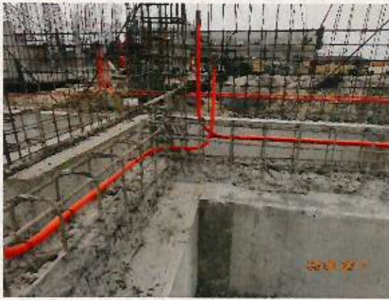
Fotografía N° 7: Excesivos restos de hormigón en enfierradura de sobrecimientos de pabellón H.
