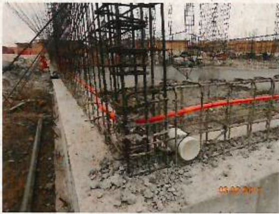
Fotografía N° 9: Excesivos restos de hormigón en enfierradura de sobrecimientos de pabellón H.
