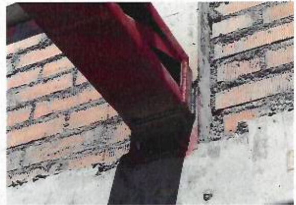
Fotografía N° 28: Fijación entre placa metálica embebida en el hormigón y cercha no ajustada a lo indicado en planos, en pabellón C (vista cercana).
