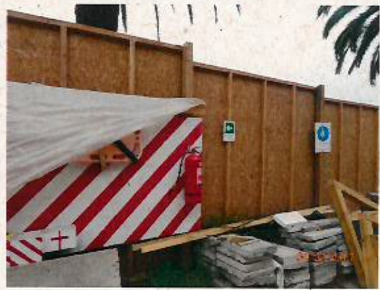
Fotografía N° 3: Extintor a la intemperie sin puerta de vidrio en su gabinete (ubicado en la obra).
