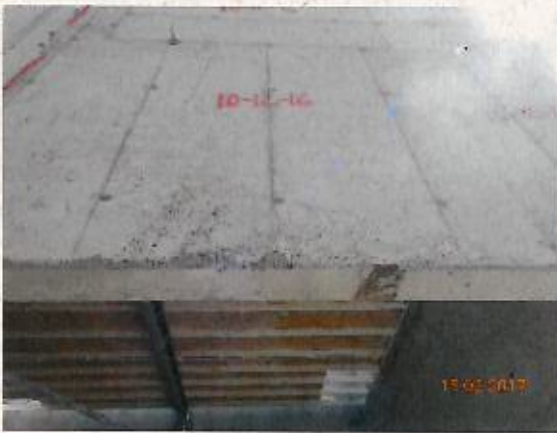
Fotografía N° 21: Nido en el dintel de la puerta de acceso sur al patio central del pabellón B, específicamente en el eje BD, entre los ejes B12 y B13 (vista general).
