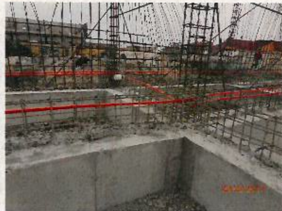
Fotografía N° 8: Excesivos restos de hormigón en enfierradura de sobrecimientos de pabellón H.
