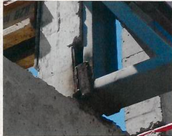
Fotografía N° 32: Falta de verticalidad de placa metálica embebida en el hormigón, en la unión de la cercha del eje CH del pabellón C (vista cercana).
