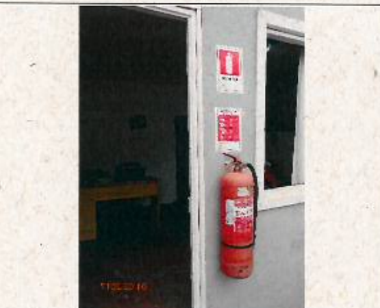
Fotografía N° 5: Extintor a la intemperie sin puerta de vidrio en su gabinete (ubicado en las oficinas administrativas).
