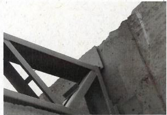
Fotografía N° 26: Fijación entre placa metálica embebida en el hormigón y cercha no ajustada a lo indicado en planos, en pabellón A (vista cercana).
