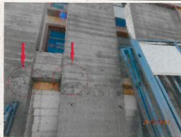
Fotografía N° 5: Nidos en el muro de hormigón armado a la vista.
