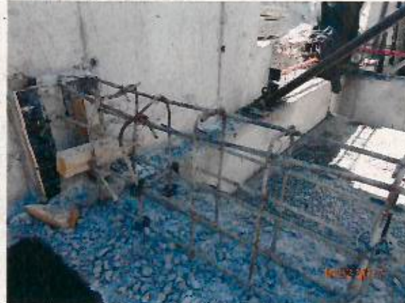
Fotografía N° 10: Enfierradura del sobrecimiento torcida y doblada, ubicada en el eje HH (entre H16 y H17) del pabellón H.
