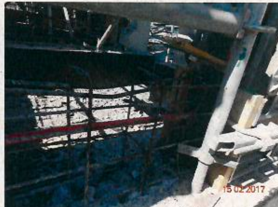
Fotografía N° 12: Enfierradura del sobrecimiento torcida y doblada, ubicada en el eje HI (entre H17 y H18) del pabellón H.
