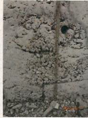
Fotografía N° 20: Segundo nido con enfierradura a la vista en muro del pabellón A, en el eje A2, entre los ejes AA y AB (vista cercana).
