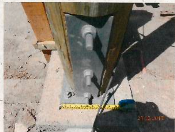
Fotografía N° 2: Anclaje de columnas de madera del patio interior no posee atiesadores indicados en plano de estructuras.
