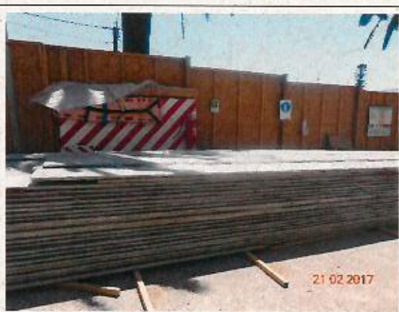
Fotografía N° 6: Extintor sin acceso expedito (ubicado en la obra).
