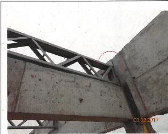
Fotografía N° 25: Fijación entre placa metálica embebida en el hormigón y cercha no ajustada a lo indicado en planos, en pabellón A (vista general).
