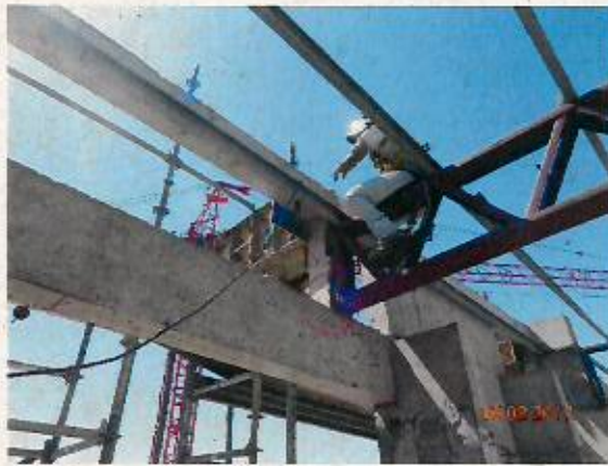
Fotografía N° 33: Las placas metálicas no se encuentran en contacto directo con el perfil metálico de la estructura de la cercha, en el eje CF (vista general).
