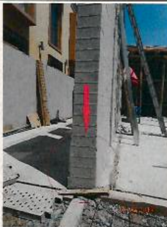
Fotografía N° 4: Deformación en muro de hormigón armado a la vista, en su extremo inferior del lado norte.
