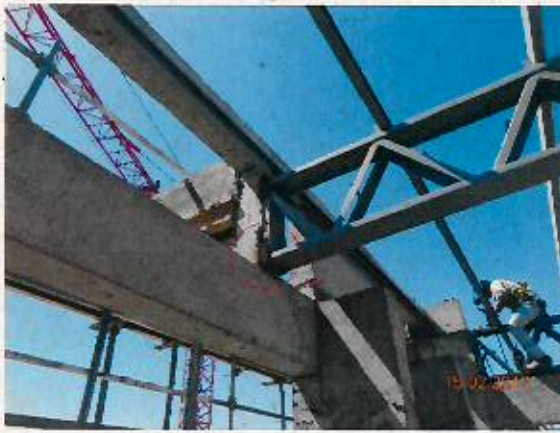
Fotografía N° 31: Falta de verticalidad de placa metálica embebida en el hormigón, en la unión de la cercha del eje CH del pabellón C (vista general).
